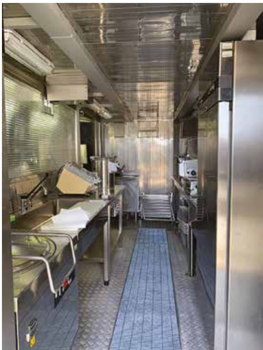
Figura 5. Cucina shelterizzata (particolare int. 2)
